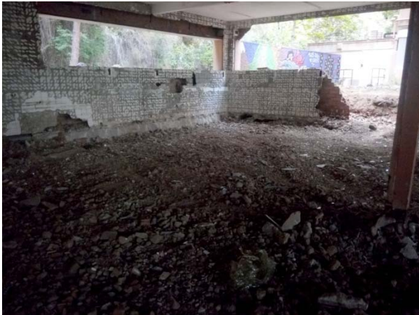
9. Vista de la zona de la cuina (sector A) una vegada finalitzats els treballs d'enderroc.
