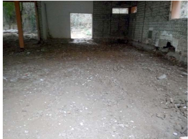
10. Vista de la zona de la cuina (sector A) una vegada finalitzats els treballs d'enderroc.
