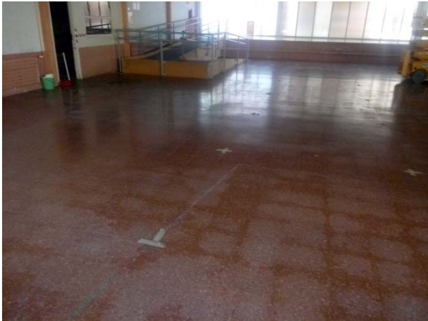
3. Vista de la sala polivalent (sector A) abans de l'inici dels treballs.
